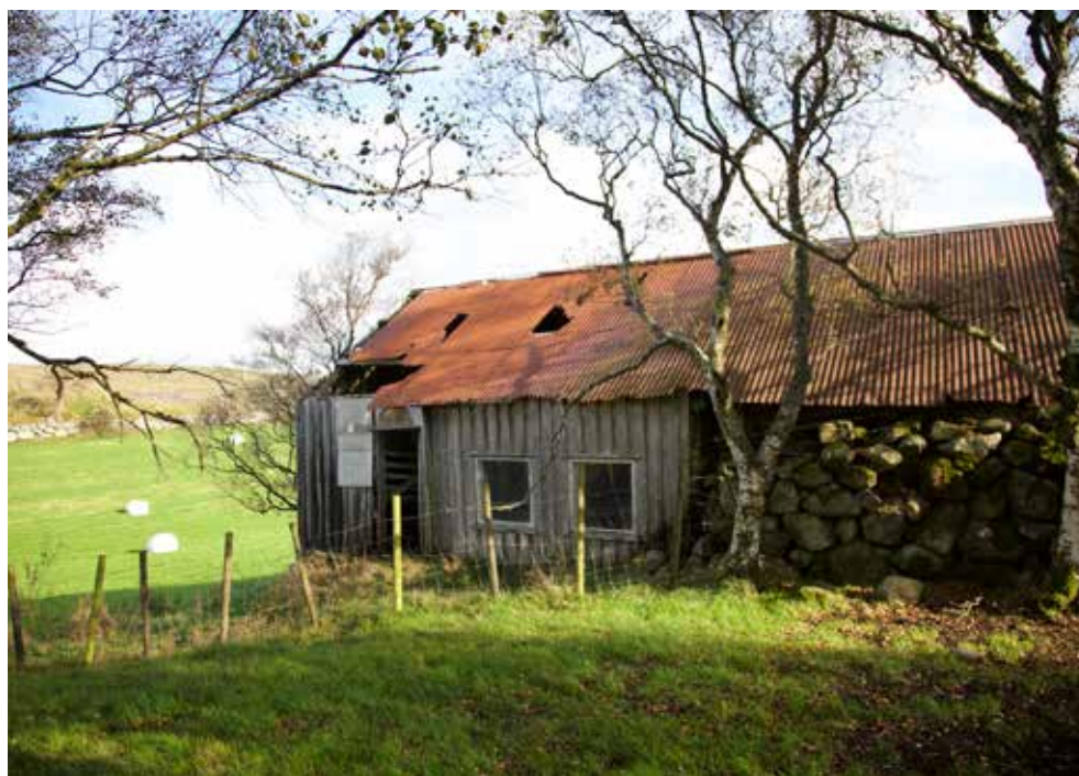
Husmannsplassen "Tuå" før restaurering. Foto: Lise Bjelland, 2021.
