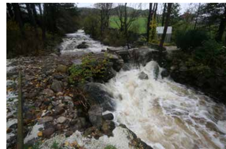
Steinbru på Aniksdal før restaurering. Foto: Privat, 2017.
